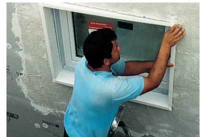
Zusammengesetztes Dämmungsanschlussprofil nach Abschluss der Wandbelagsarbeiten in die durch das Entfernen der Schalungsabdichtung entstandene Nut einsetzen.
