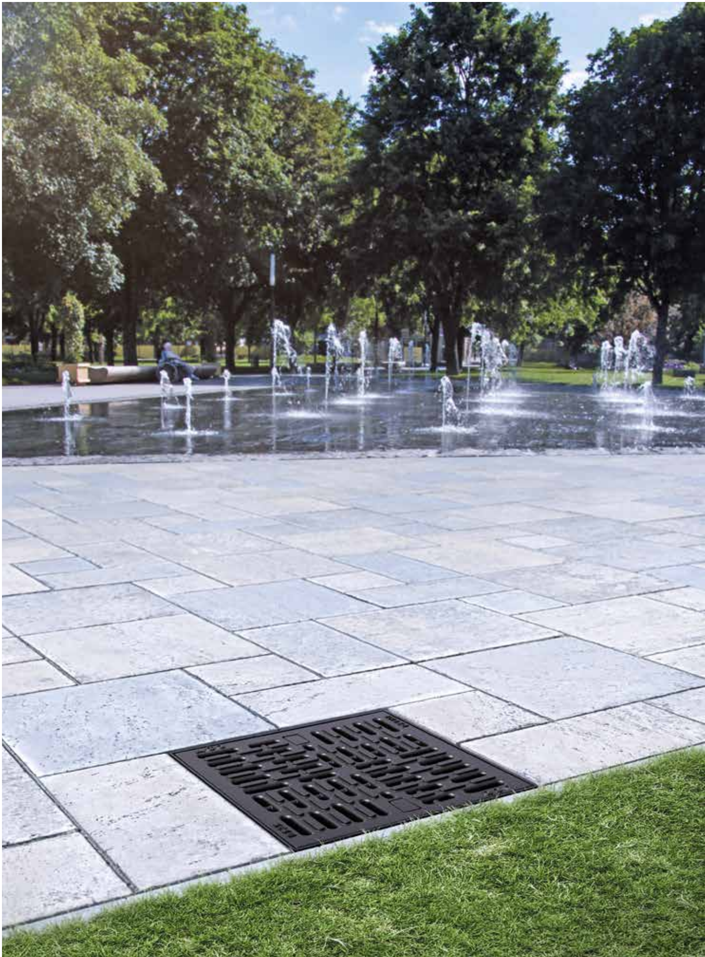
Auch in Parkanlagen sind Punktabläufe eine gute Sammelstelle für Schmutz- und Regenwasser
