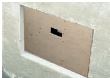
5. Die äußere und die innere Stützplatte verbleiben bis zum Abschluss der Rohbauphase zum Schutz vor Beschädigungen in dem Leibungsfenster.
