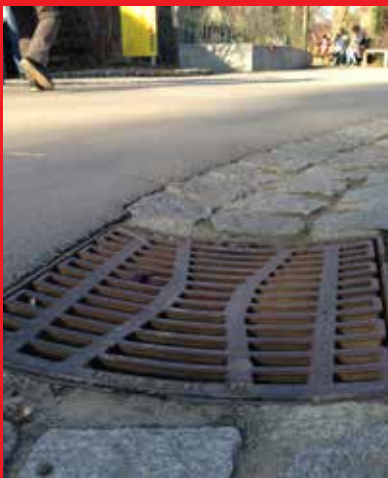
ACO Combipoint PP in der Fußgängerzone
