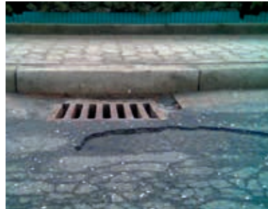
Schadenstyp A Setzungen der angrenzenden Umgebung – Aufsatz bleibt stehen, Unterspülungen – Absenkungen – Frostschäden
