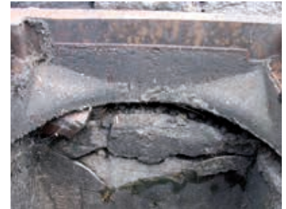
Schadenstyp B Zerstörung der Mörtelfugen und/oder der Betonteile durch Verkehrsbelastung – Aufsatz sinkt ab – Beläge brechen ab
