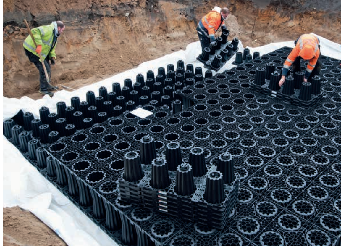
Referenz Heider Marktpassage, Heide: ACO Stormbrixx HD als Versickerungsrigole unterhalb von PKW-Stellflächen.
