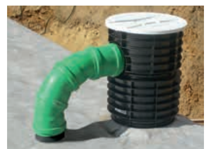
Erstellen einer Be- und Entlüftung: Ein Rohrbogen verbindet Oberteil mit Stutzen und Rohrschlussadapter
