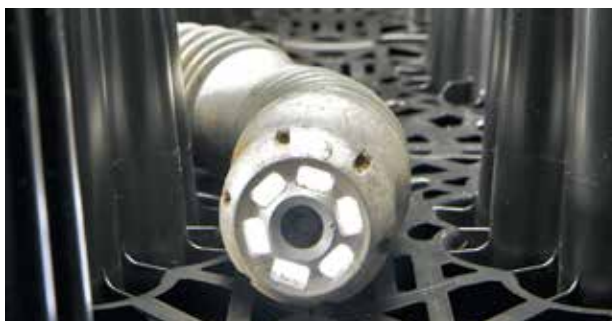
Schiebekamera, Reinigungsgerät mit Spülkopf
