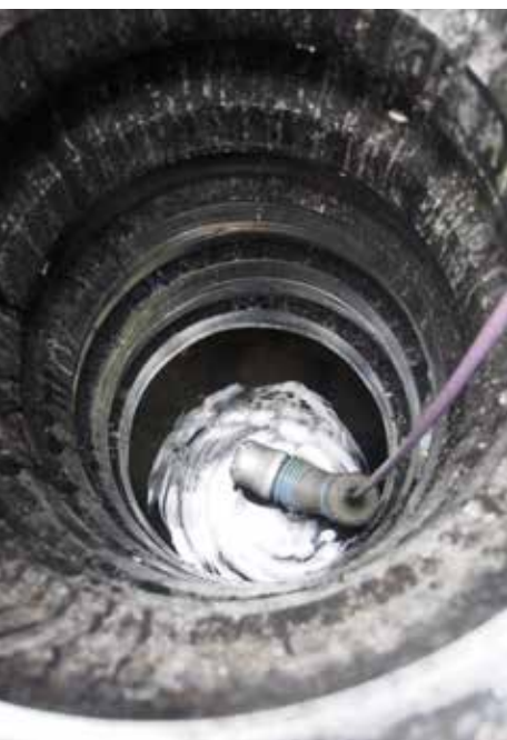
Vertikaler Zugang direkt über der Rigole
