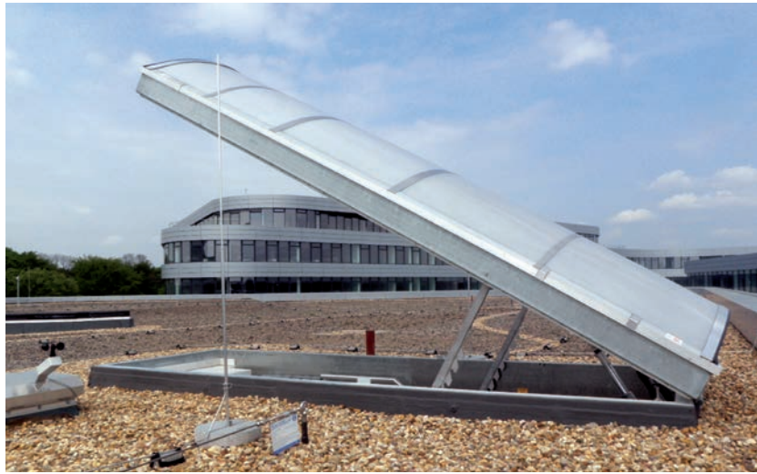
Hydraulisch betriebener Dachausgang und RWA-Klappe, Köln
