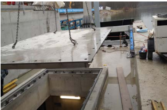
Überflutungssichere Abdeckung auf einer Montageöffnung, Ansicht von unten, Donaukraftwerk bei Augsburg
