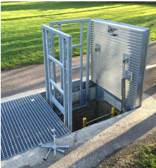
Notausstieg mit teleskopierbaren Geländer, Leverkusen
