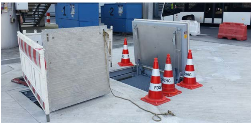
Zugangs- und Montageöffnungen, F900, Düsseldorf
