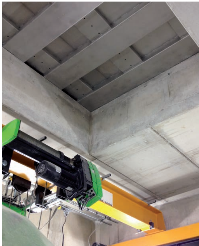
Überflutungssichere Abdeckung auf einer Montageöffnung, Ansicht von unten, Donaukraftwerk bei Augsburg
