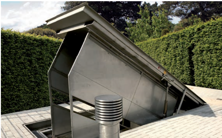
Einstieg in Pumpwerk, Seligenstadt
