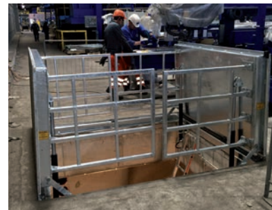
Hydraulische Schachtabdeckung als Montageöffnung mit Einfallschutz, befahrbar mit Gabelstapler, Krefeld
