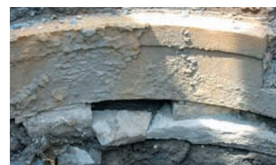
Häufiges Schadenbild einer zerstörten Mörtelfuge
